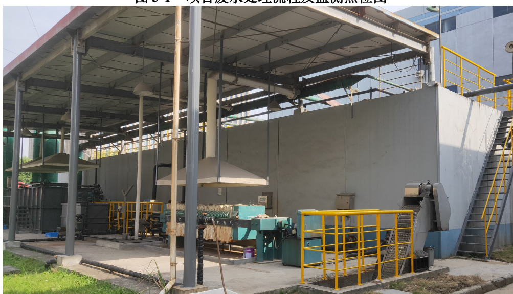
园区现有污水处理站
