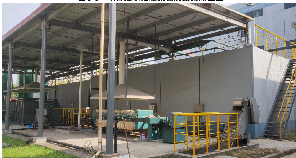
园区现有污水处理站
