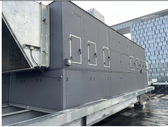
高效过滤器过滤+喷淋除臭设备2
