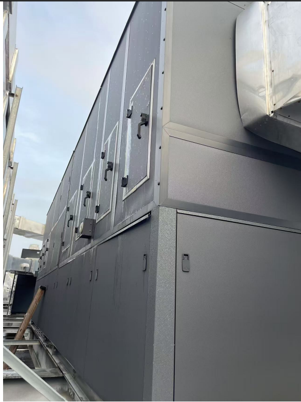
高效过滤器过滤+喷淋除臭设备3
