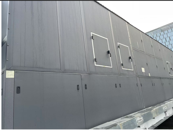
高效过滤器过滤+喷淋除臭设备1
