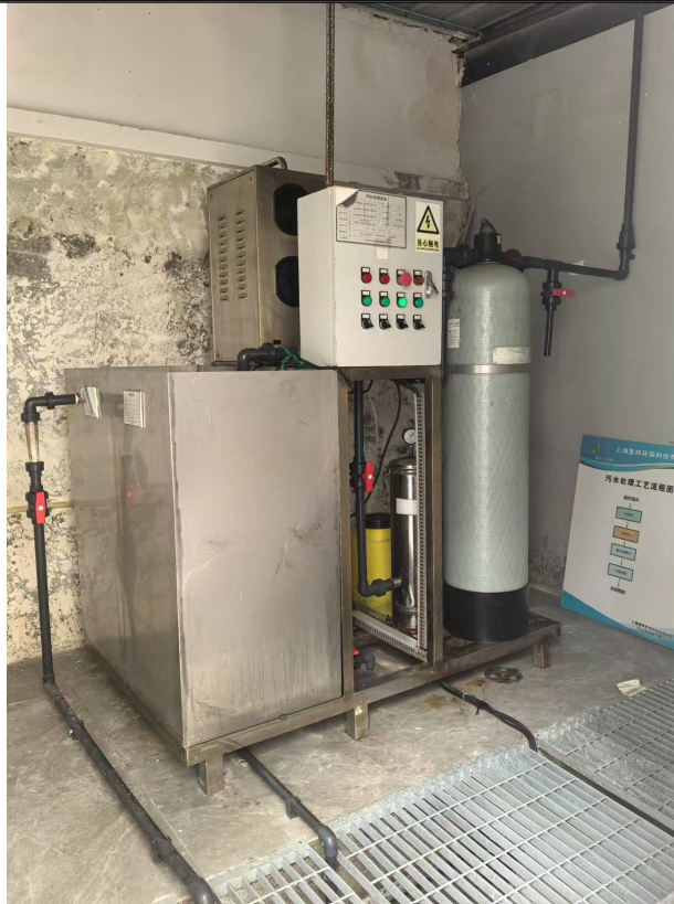
废水预处理设施
