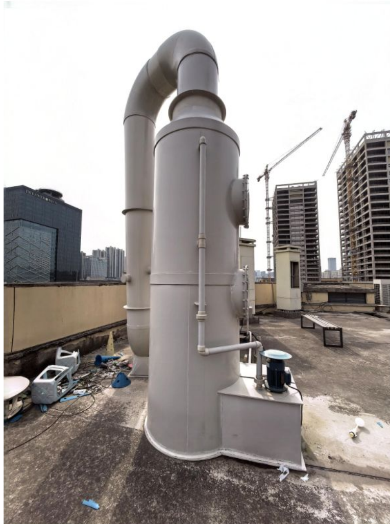
喷淋装置及排气筒
